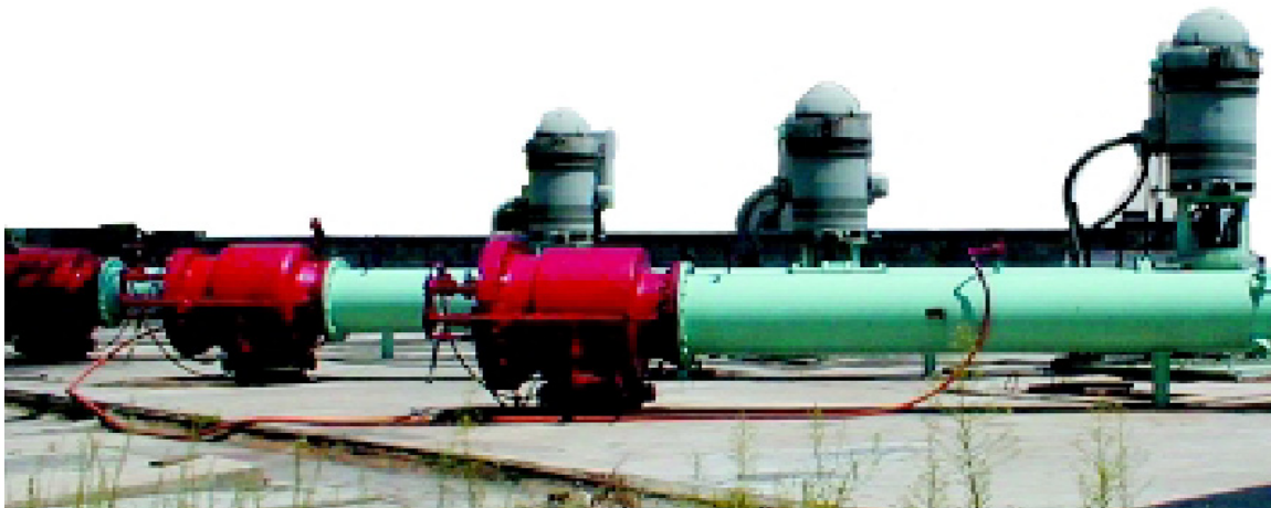
Un amplio sistema acuífero está revisado y controlado utilizando radio modems inalámbricos, y hardware y software de Opto 22.
